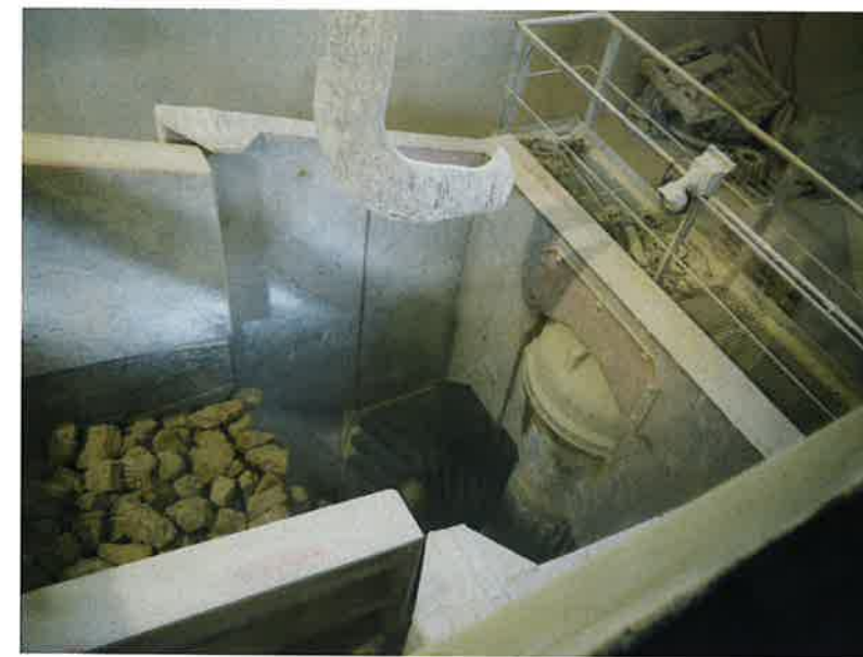
Bild 7: An automatische Fettschmierversorgung anzuschließender Backenkreiselbrecher
