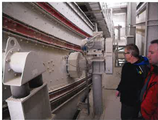
Bild 5: Förderband mit Schmierstelle
