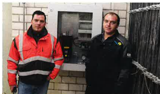
Bild 6: Betriebsleiter Pranghofer und Servicetechniker Oswald vor staubdichtem Elektronikschaltschrank mit Kontrollfenster
